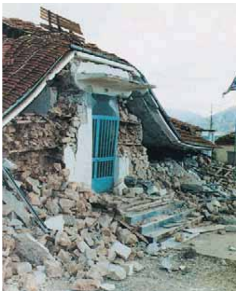
Εικόνα 27.1α: Καταστροφή από σεισμό
